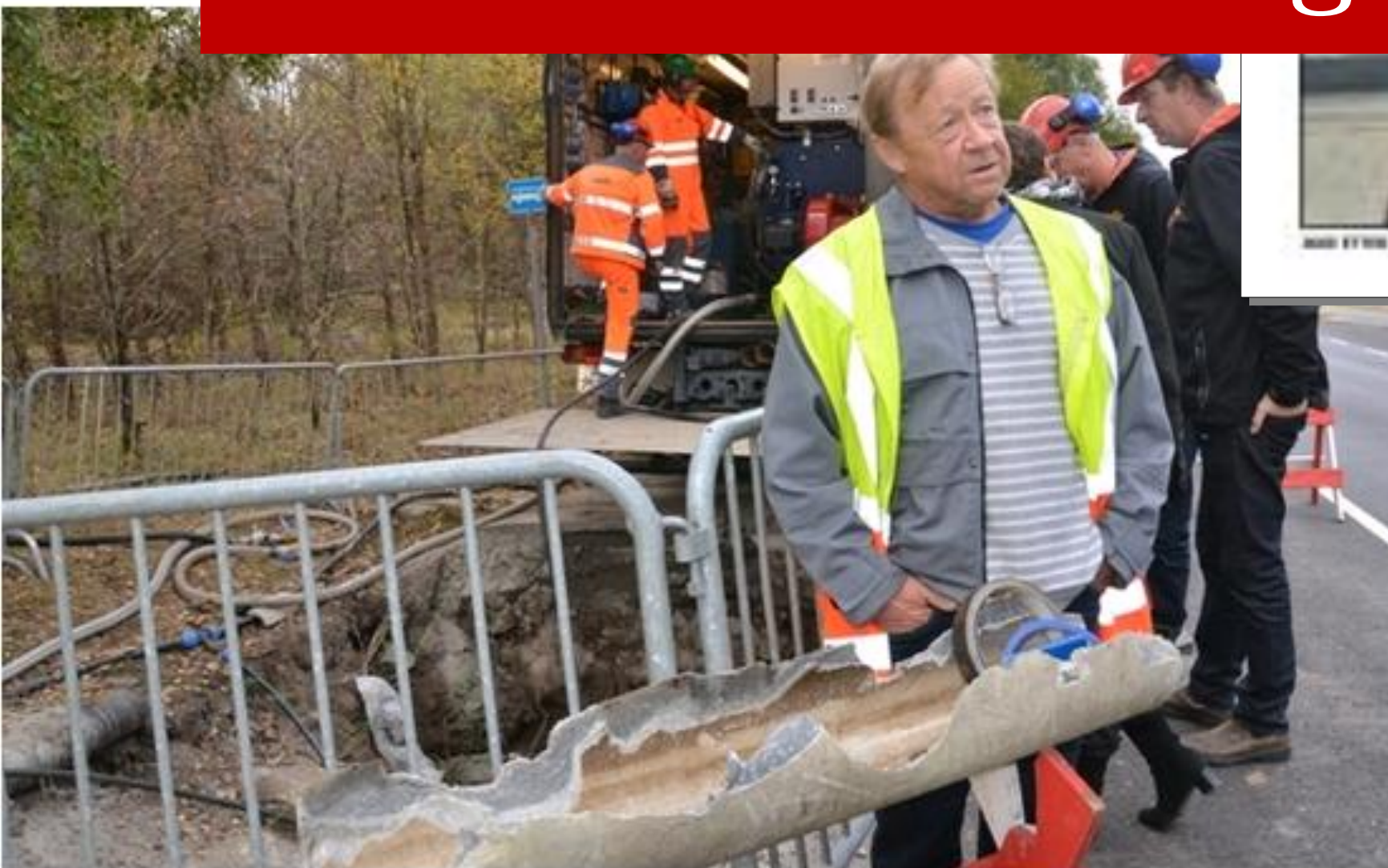
Gjentatte ledningsbrudd i en rekke norske kommuner har ført til et vanntap av enorme dimensjoner. Illustrasjonsbilde
